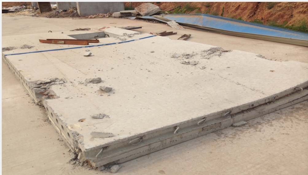
砼劈裂破坏，起吊埋件被拔出
